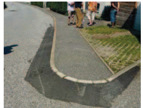
Zu steile Rampen für RollstuhlfahrerInnen und Personen mit Rollatoren
